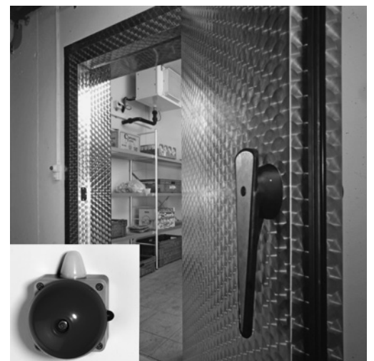
Bild 8: Der Alarm im Tiefkühlraum muss jederzeit gehört werden.
